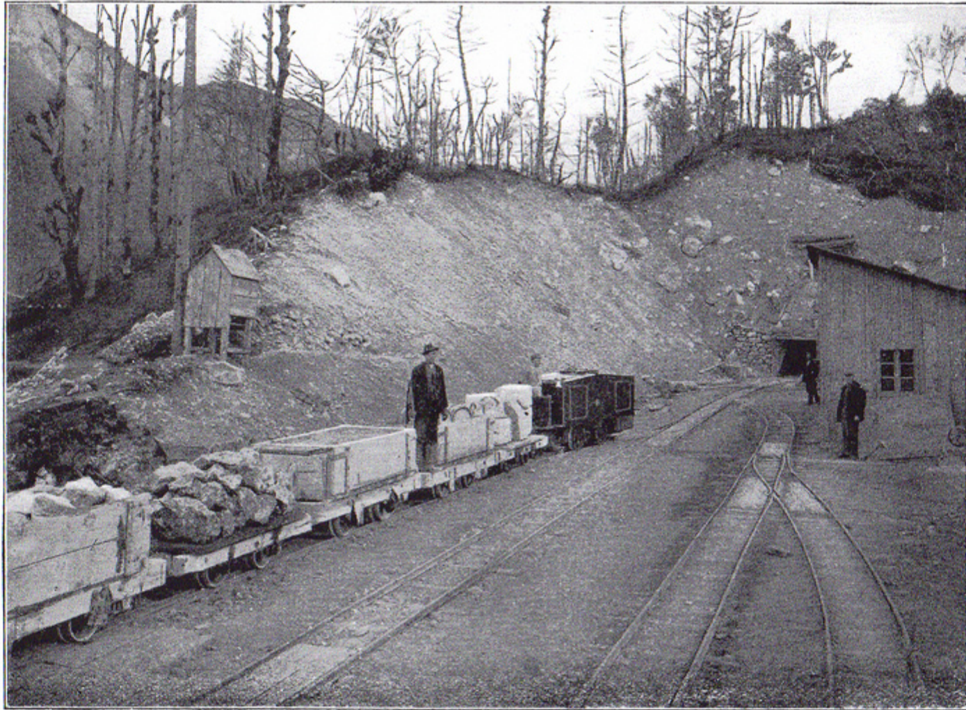
2 Stück zum Tunnelbau im Betriebe bei der Unternehmung H. Rella & Co. in Wocheiner-Vellach, Oberkrain.
